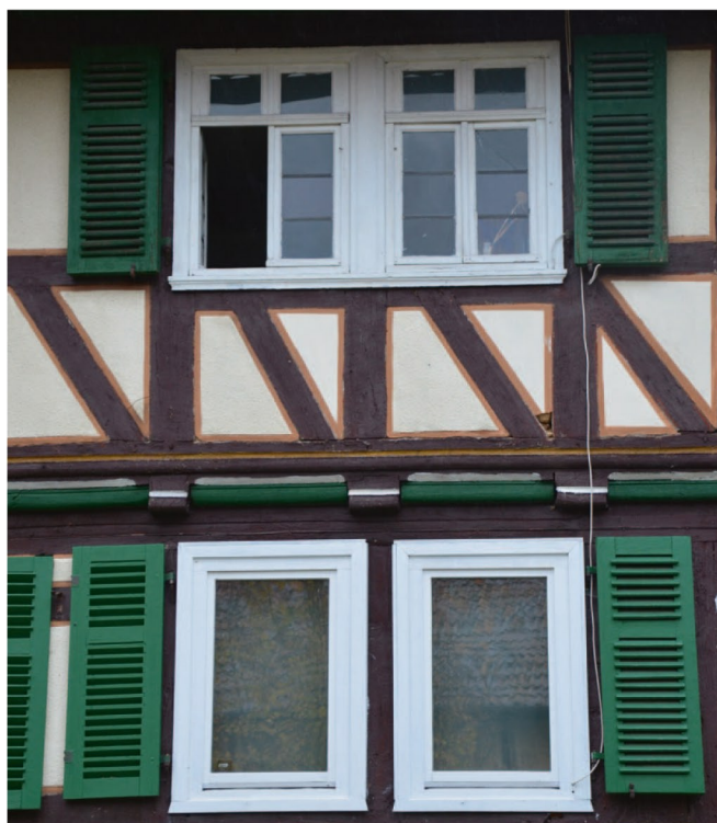
Abb. 1: Beeinträchtigung des Erscheinungsbildes einer Fachwerkfassade durch Fensteraustausch. (Foto: G. Stein)
